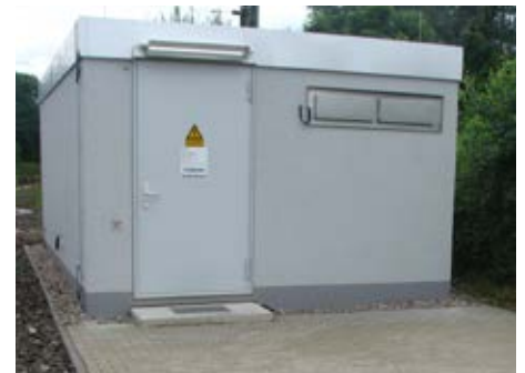
Am Haltepunkt Lindau-Aeschach entsteht ein neuer Schaltposten, der die Strecken Friedrichshafen - Lindau und (München -) Buchloe - Lindau voneinander trennt.
